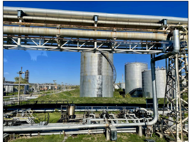
Raffinerie de pétrole en Hongrie. (Photo mad)
